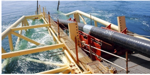
Σχήμα 2-1: Αγωγός μεταφοράς αερίου τύπου XXX.
